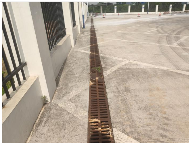
厂内现有雨水收集管
