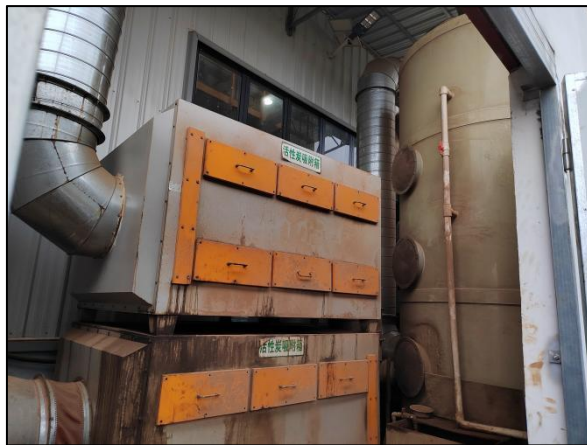
现有项目喷淋塔+二级活性炭吸附装置
