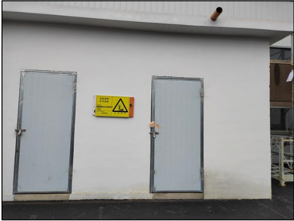
现有项目危废暂存间
