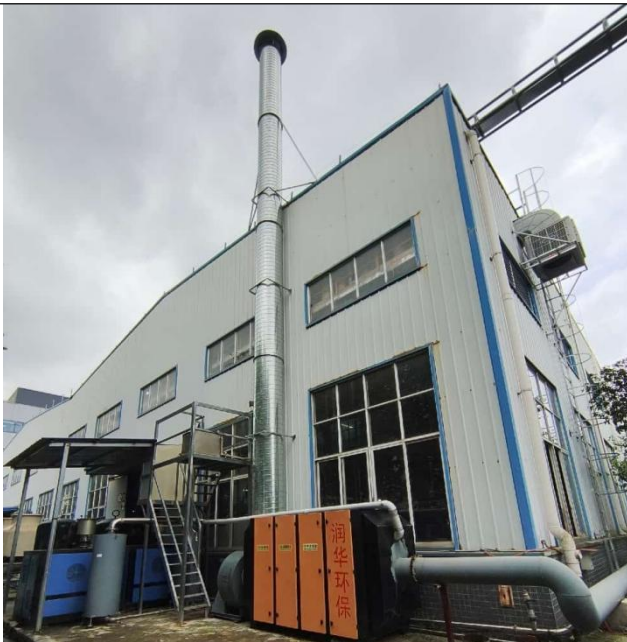
项目有机废气处理装置及 1#排气筒
